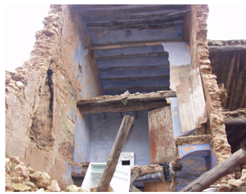
③崩落したマジアの断面。屋根と床の構成が見える
