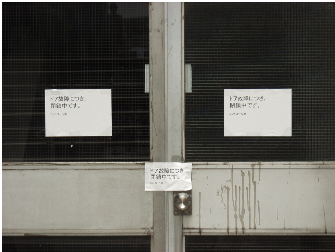
写真1 建物によくあるトラブル
