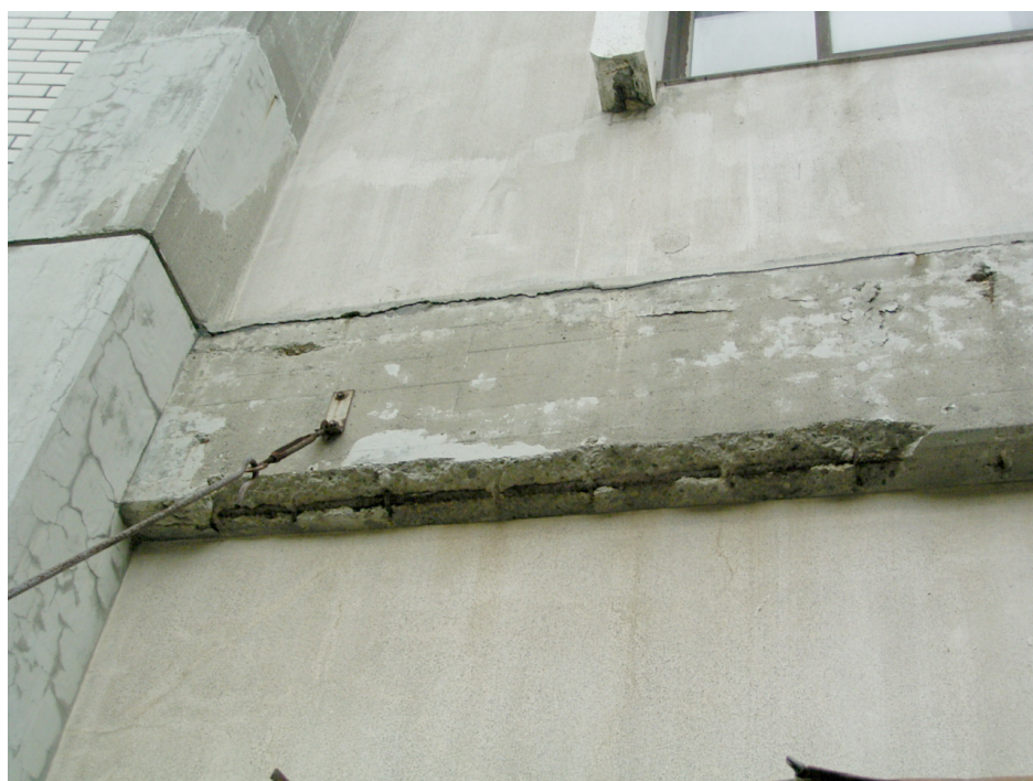
写真2 コンクリートが剥落し主筋が露出している
